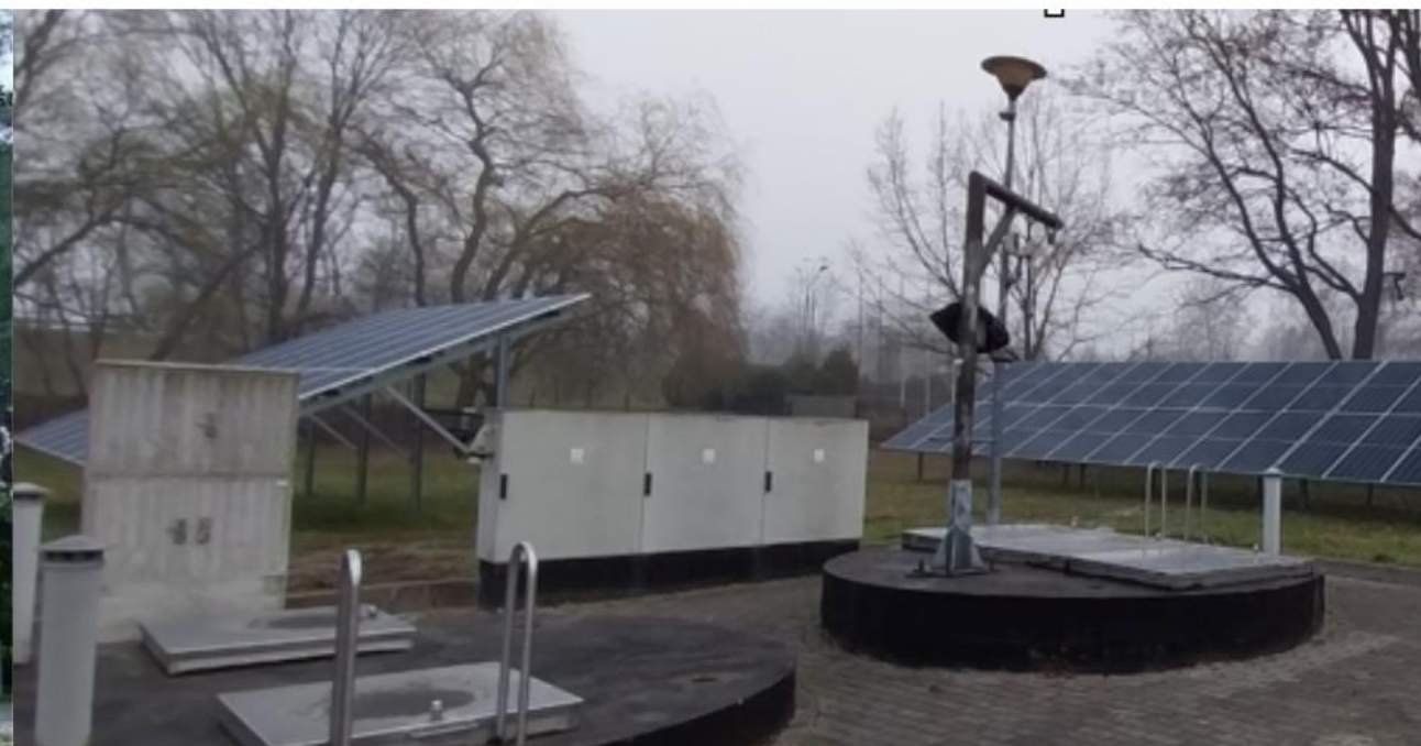
PRZEPOMPOWNIA ŚCIEKÓW PKR1 UL. MAKSYMILIANA
