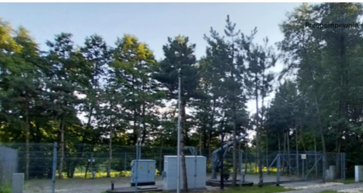
PRZEPOMPOWNIA ŚCIEKÓW PZ1 UL. PEŁCZYŃSKIEGO
